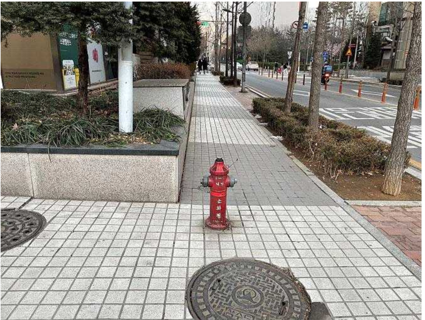
▲ 부천시 중동 위브더스테이트 앞 인도에 설치된 옥외소화전. 주변에 보호틀이 없어 안전사고가 우려된다.
