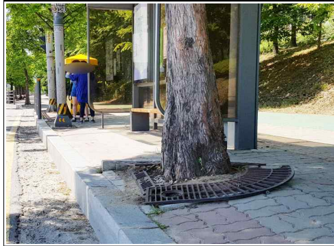
가로수 철계(주철) 보호덮게 및 경계석 보도면 돌출 전도 안전사고 상존(사례2)
