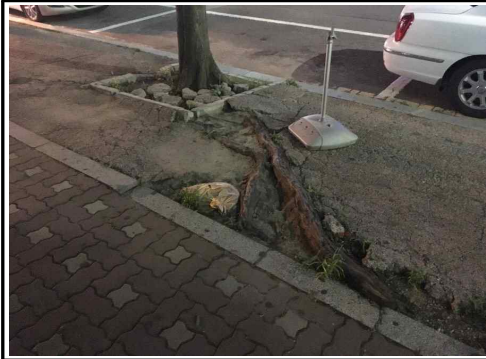
가로수 뿌리 및 경계석 보도면 돌출 전도 안전사고 상존(사례1)
